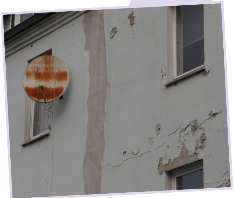
Teil der Fassade einer Problemimmobilie in Gelsenkirchen
